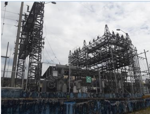
Figura 1. Vista parcial de la subestación Eléctrica Celso Castellanos.
