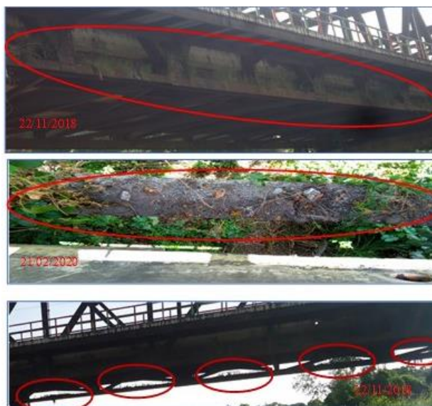
Figura 5. Acumulación de escombros en el alma de la viga. Fuente: los autores
