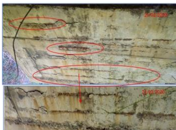
Figura 6. Sangrado del concreto. Fuente: los autores
