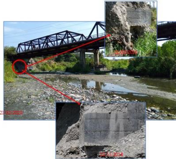
Figura 3. Socavación de la base del puente. Fuente: los autores
