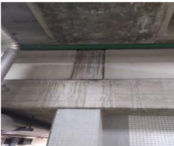
Figura 6. Manchas en vigas. Fuente: los autores
