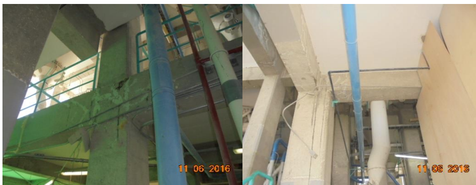
Figura 10, Daño en losa de Mezanine del Bloque de Harina. Nivel 8.0 m.
