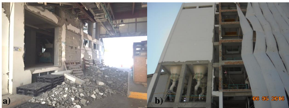
Figura 5. Daño en mampostería en niveles: a) 0,0 m, b) 3.50 m. Fuente: W. Mera [2]
