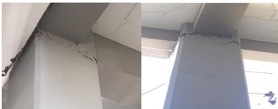
Figura 9. Inicio de daño estructural en cabeza de columnas de segundo piso del Bloque de Harina. Fuente: [6].
