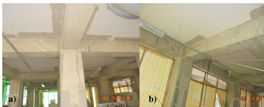
Figura 6a y 6b. Daño en vigas de primer piso alto, de Silos de Harina. Nivel 3.50 m.
